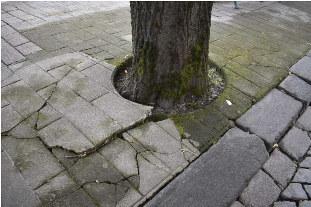
Figura 2.6 – Árvore 15, deformação do pavimento por este ser impermeável e as caldeiras serem pequenas.
